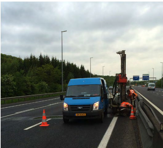
Forage de reconnaissance sur l'autoroute A3 pour l'étude d'un nouvel ouvrage d'art
